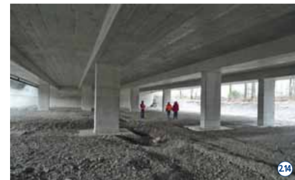
Ein wichtiger Bestandteil der ökologischen Aufwertung des Hänggelgiessens ist die Wildtierunterführung der Nationalstrasse A3 (Projekt ASTRA). 2.14
