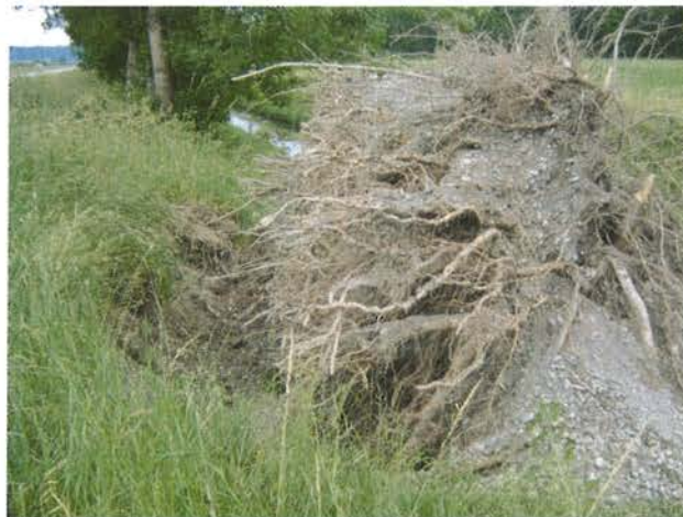
Bild 7: Ausgerissener Wurzelstock im Damm
